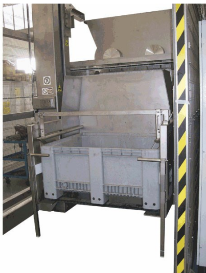
Sistema elevador automático
