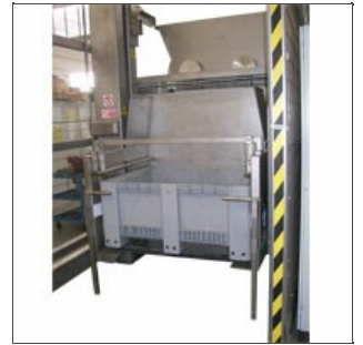
Sistema elevador automático
